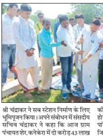
श्री चंद्रकार ने सब स्टेशन निर्माण के लिए भूमिपूजन किया। अपने संबोधन में सचिव सचिव चंद्रकार ने कहा कि आज ग्राम पंचायत गुरुसंकेत में दो करोड़ 43 लाख की लागत से विद्युत सब स्टेशन का निर्माण होने जा रहा है।
